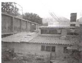
El tejado del centro sufrió algunas reparaciones
