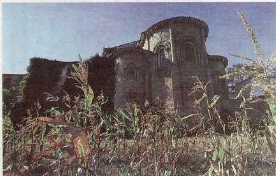
Las hiedras cubren desde hace tiempo parte de los muros de la construcción, contribuyendo a su deterioro
